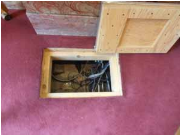
Fig. 2.4.A.31 – Supply air plenum
