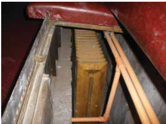
Fig. 2.4.A.26 – Supply air plenum
