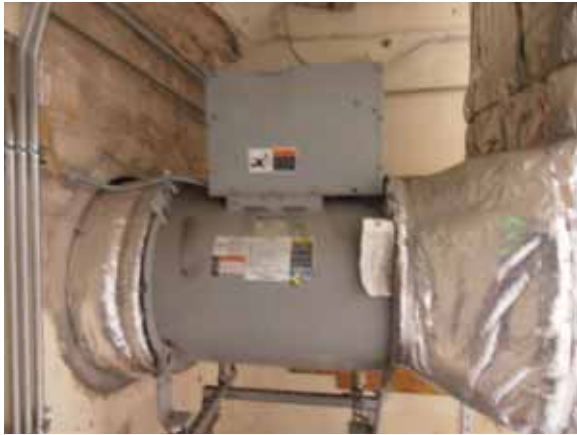
Fig. 2.4.A.36 Stairwell Pressurization Fan
