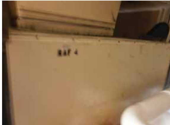
Fig. 2.4.A.24 – Basement AHU -Return Air Fan
