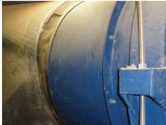
Fig. 2.4.A.13 – Return air fans
